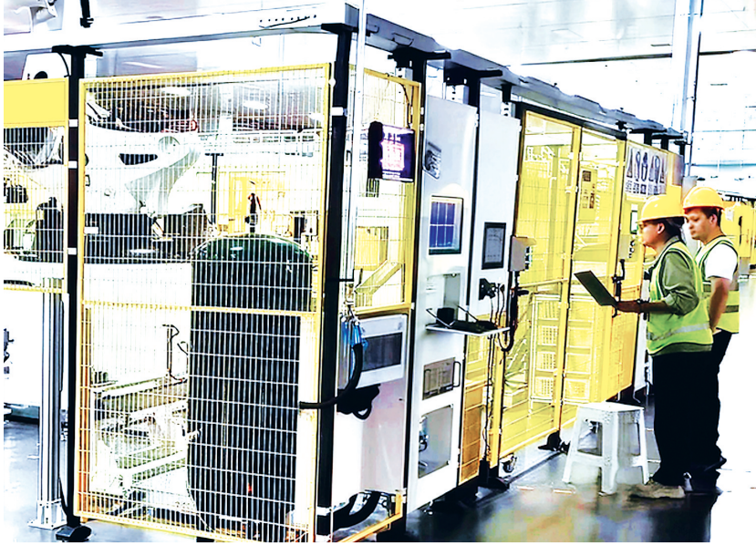
宝鸡闪聚动力电池工厂项目工作人员正在调试设备
