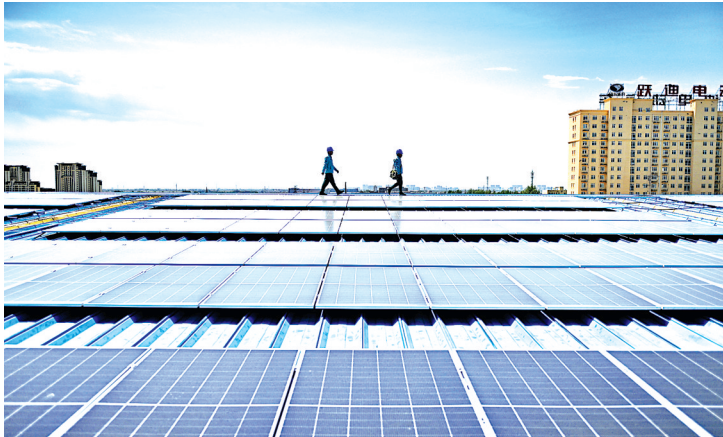
国网元氏县供电公司工作人员在河北省元氏县一家科技型企业屋顶光伏电站巡检(资料图)。 新华社记者 牟宇/摄
