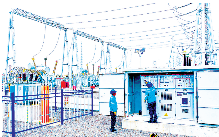
上图:供电公司工作人员对新型镍氢混合共享储能示范项目变压器进行巡检(无人机照片)。
