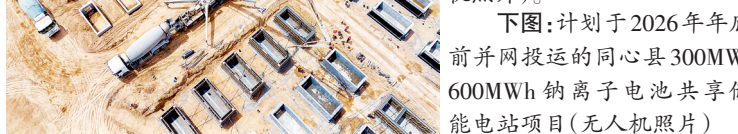
下图:计划于2026年年底前并网投运的同心县300MW/600MWh钠离子电池共享储能电站项目(无人机照片)
