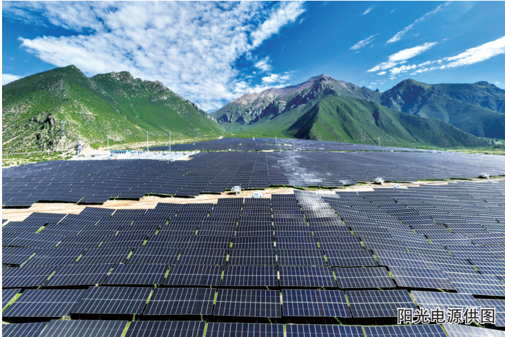
阳光电源西藏墨竹工卡扎雪100MW牧光互补项目
