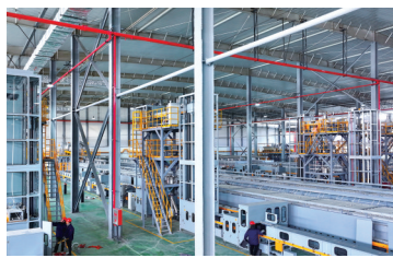
锂电产业园年产10万吨磷酸锰铁锂正极材料项目加速推进。
