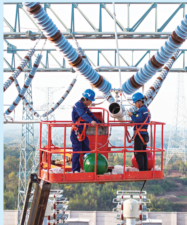
11月8日,一台车货总重达529吨的换流变压器送入“宁电入湘”工程衡阳换流站,标志着首台换流变压器运输任务圆满完成,“宁电入湘”工程湖南段全面进入电气安装高峰期。
