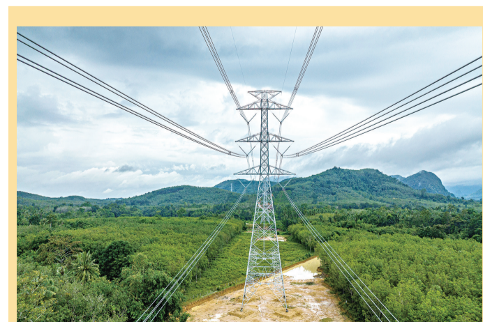
中企承建的泰国500千伏董颂-宋卡输电线路项目12月19日举行竣工仪式。该项目由国家电网河南送变电建设有限公司承建,途经泰国南部那空是贪玛叻府与博他仑府,总长105公里。
