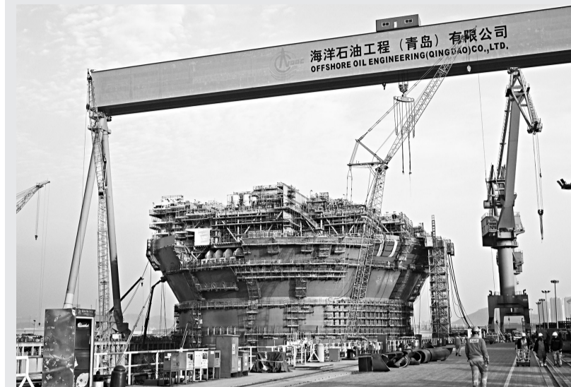
近日,由我国自主设计建造的亚洲首艘圆筒型“海上油气加工厂”——“海洋石油122”浮式生产储卸油装置(FPSO),在青岛进入最后的总装集成冲刺阶段。据介绍,“海洋石油122”船体直径约90米,设计排水量10万吨,可连续海上作业15年不回坞。图为在海洋石油工程(青岛)有限公司生产基地,工人对“海洋石油122”进行上部模块总装作业。新华社记者 李紫恒/摄
