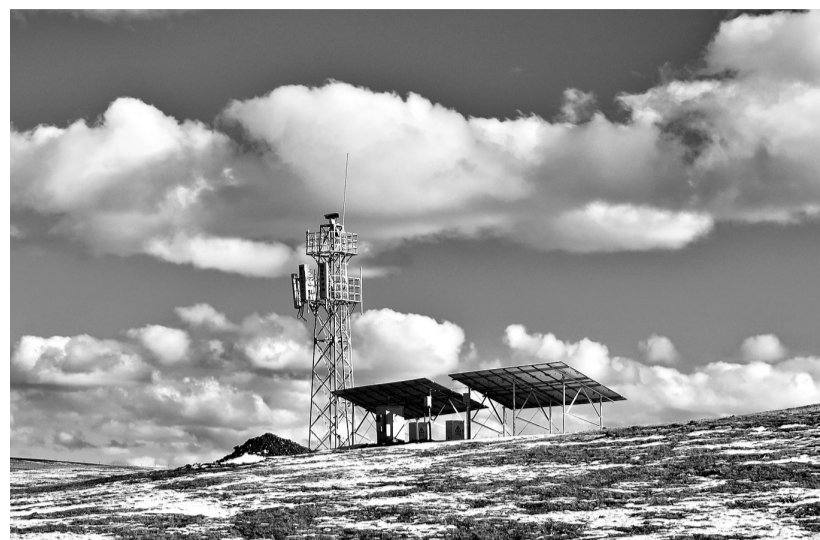
2023年,青海省玉树藏族自治州启动了长江、黄河、澜沧江源头生态环境远程监管和5G覆盖项目。中国移动通信集团青海有限公司等通信企业在长江源流域当曲、黄河源流域约古宗列曲和澜沧江源流域扎西齐哇架设5G基站,5G网络覆盖至周边地区5公里。三江源源头重要地区告别“通信盲区”,实现了对区域内生态类型、自然景观及野生动物的“远距离、大范围、全方位”实时高清视频监控。图为在玉树州曲麻莱县黄河源流域约古宗列曲拍摄的中国移动5G基站。 新华社记者 韩方方/摄
