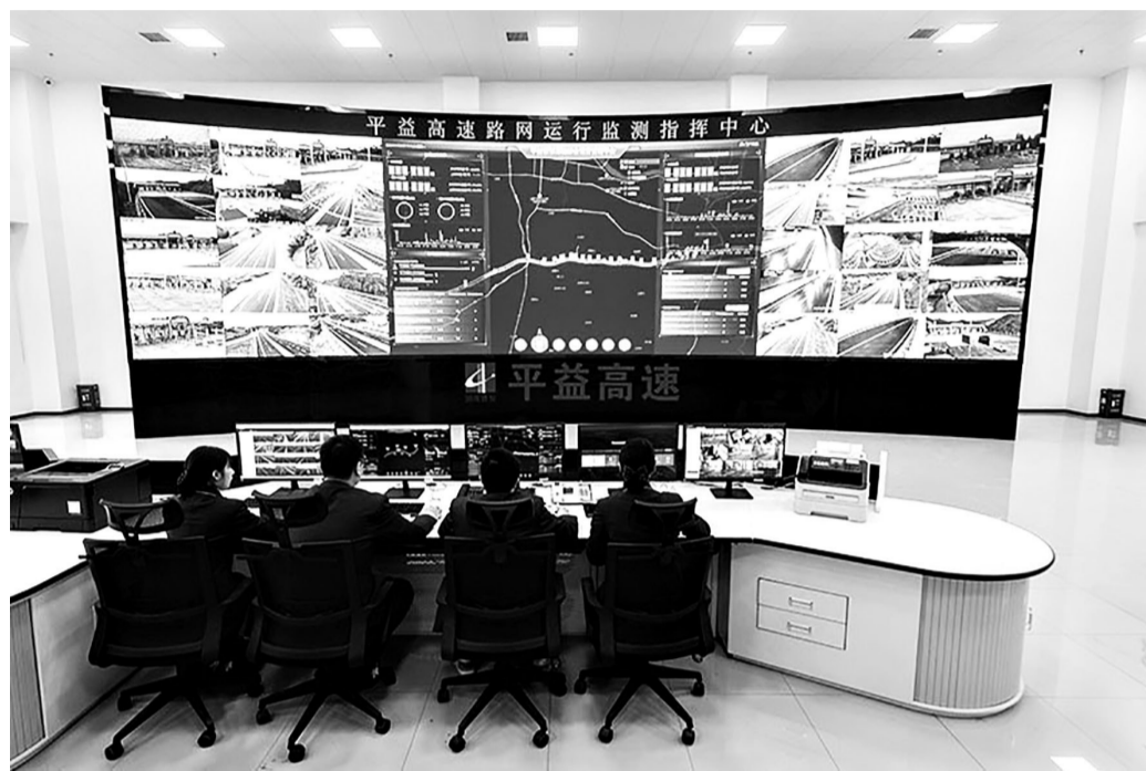
湖南首条智慧高速平益高速路网运行监测指挥中心
