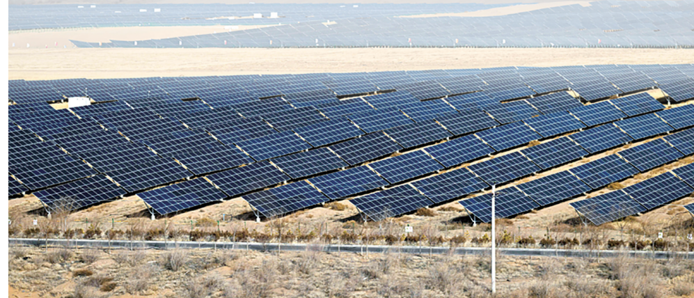
内蒙古鄂尔多斯市达拉特旗光伏发电基地
