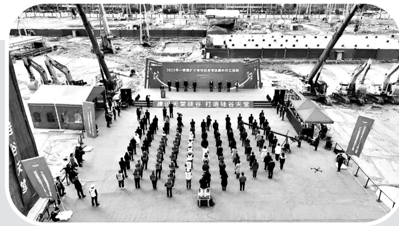
近日,杭州高新区(滨江)举行一季度扩大有效投资项目集中开工活动。此次活动共涉及项目29个,计划总投资117亿元。这些项目落成后,将进一步强化杭州高新区(滨江)产业支撑、提升城市能级、增强发展动力,为展现亚运核心风采、打造“天堂硅谷、硅谷天堂”注入源动力。 吕寿承 朱浩/摄
