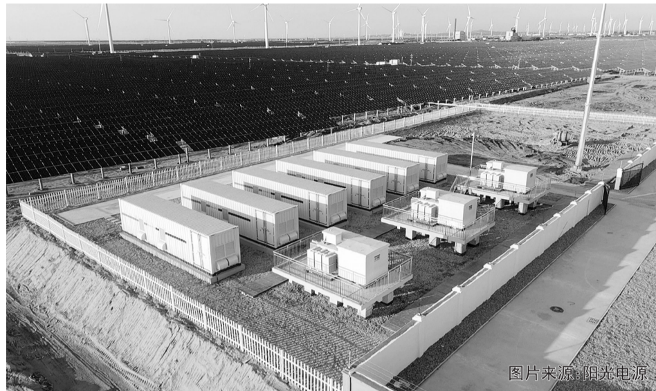
阳光电源山东26MW/52MWh交流侧耦合储能项目
