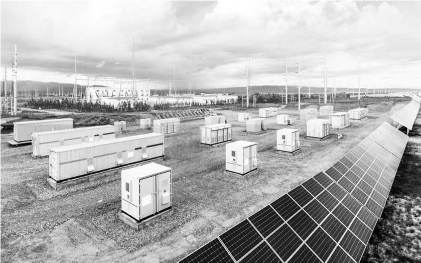
阳光电源储能项目
