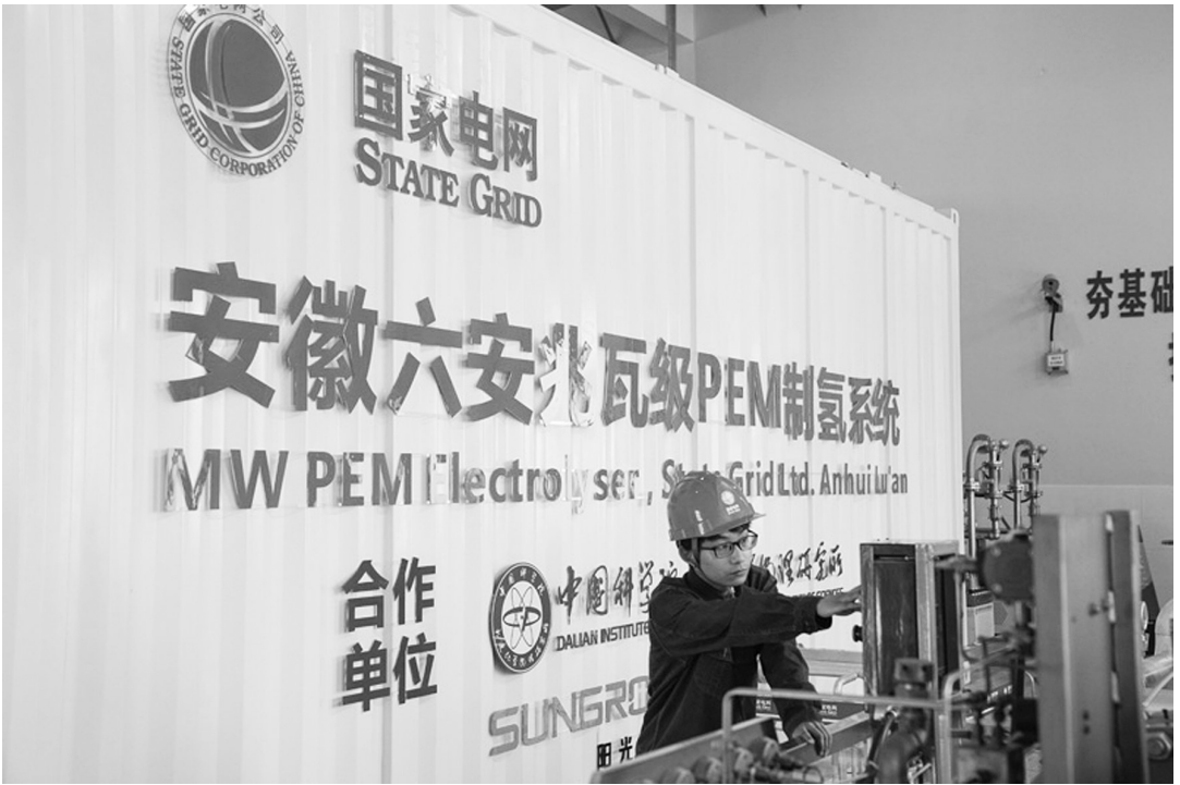
近日，国内首座兆瓦级氢能综合利用示范站在安徽六安投运，标志着我国首次实现兆瓦级制氢—储氢—氢能发电的全链条技术贯通。该示范站由国网安徽省电力有限公司投资建设，额定装机容量 1 兆瓦，占地面积 7000 余平方米。采用先进的质子交换膜水电解制氢技术，清洁零碳，年制氢可达 70 余万标立方、氢发电 73 万千瓦时，对于推动氢能研究应用、服务新型电力系统建设具有重要的示范引领作用。图为工作人员在制氢车间内操作设备。
