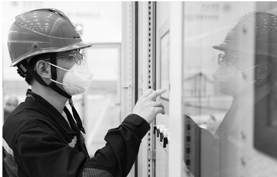
工作人员在国网新源黑龙江荒沟抽水蓄能电站的地下厂房中作业。
