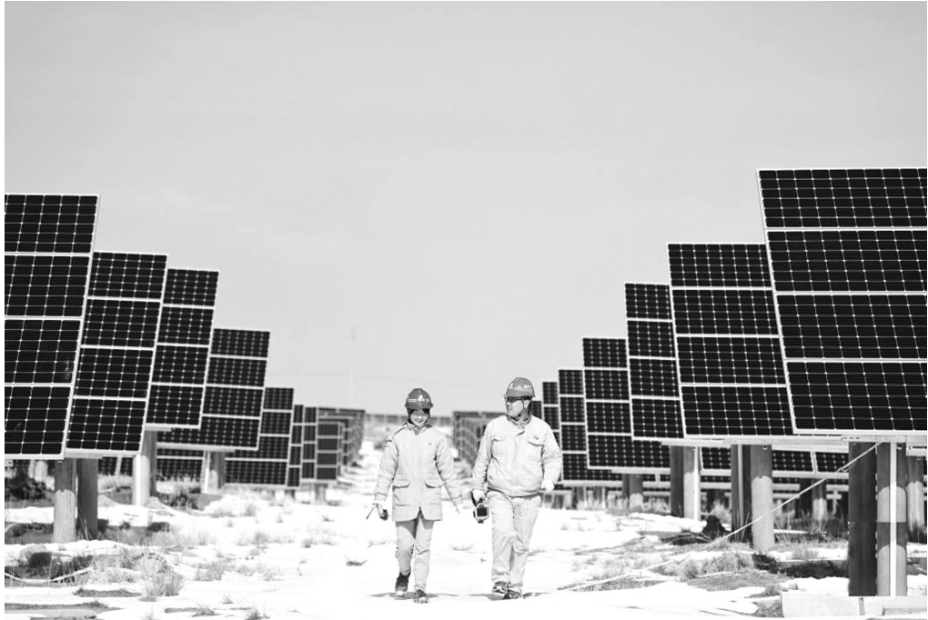
近日，青海省多地迎来较大强度降温降雪天气。为保证发电设备和线路安全稳定，大唐青海能源开发有限公司组织专业人员，加强对青海省海南藏族自治州共和县塔拉滩光伏电站巡检工作，及时掌握设备的运行状况，以确保恶劣天气下发电设备安全稳定运行，保障电力供应。图为工作人员在塔拉滩光伏电站巡检。 新华社记者 张龙/摄
