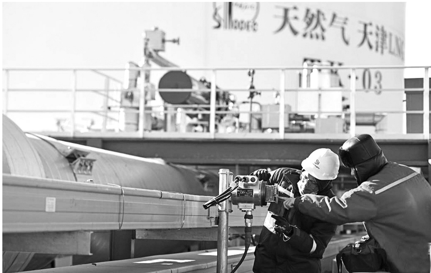
近日,一艘满载6.9万吨液化天然气(LNG)的运输船成功靠泊中国石化天津LNG接收站“2号泊位”,标志着中国石化天津LNG接收站主体工程——“双泊位”LNG码头正式投用。接收站LNG年接卸能力由600万吨提升至1080万吨,进一步增强了天然气供应能力。据了解,中国石化天津LNG接收站位于天津市滨海新区南港工业园区,是华北地区天然气调峰保供的重要组成部分。图为工作人员在中国石化天津LNG接收站“2号泊位”上检查输气管道参数。 新华社记者 赵子硕/摄
