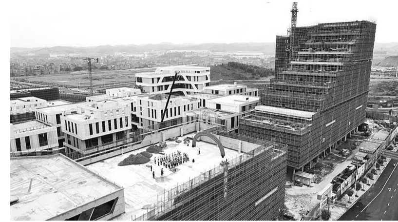
东盟多式联运智慧产业城项目主体工程提前全面封顶。 黄红锦/摄
