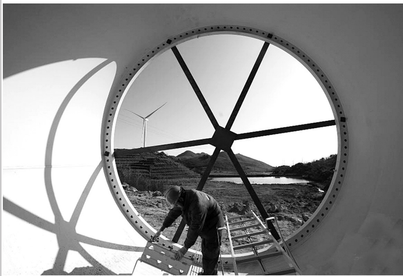
近年来,广西壮族自治区龙胜各族自治县充分利用丰富的风能资源,加快发展风力发电等清洁能源产业。目前正在建的南山风电项目利用境内高山草甸建设50台风力发电机组,总装机容量99兆瓦,预计今年年底并网发电。图为近日在龙胜各族自治县平等镇南山风电项目建筑工地,施工人员在安装风力发电设备。新华社发 黄勇丹/摄
