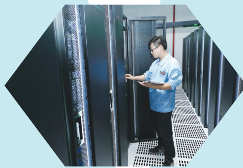
技术人员检测机柜运行情况
