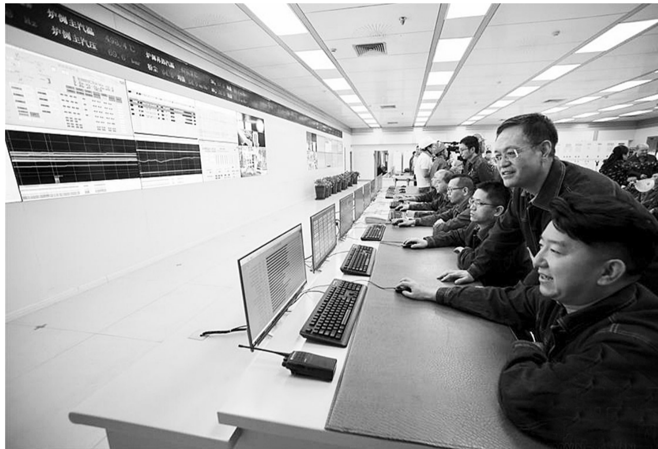
近日,由中国华能集团西安热工研究院自主研发的我国发电领域首套全国产化分散控制系统(DCS)在华能福州电厂2号机组成功投用,标志着我国发电工业控制系统实现自主可控。该系统是电厂的控制中枢,可实现锅炉、汽轮机、发电机等设备的全覆盖控制。图为工程技术人员在华能福州电厂主控室实时查看分散控制系统运行情况。
