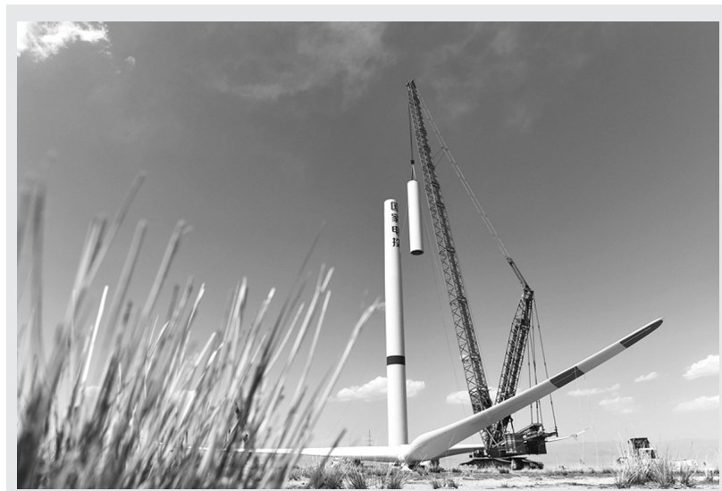
目前,青海—河南±800千伏特高压直流输电工程配套电源建设正稳步推进中。据悉,该工程是世界上第一条专为清洁能源外送建设的高压通道,全部采用光伏、风力等清洁能源。图为吊装机组在青海省共和县黄河水电公司130万千瓦风力发电项目现场进行吊装作业。
