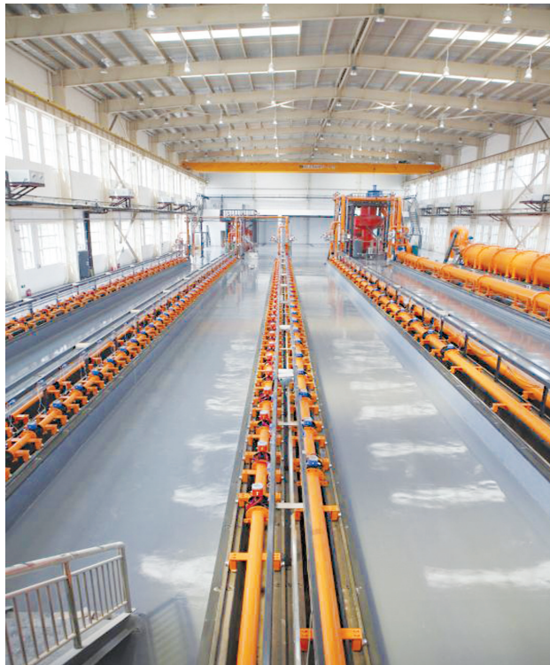
汇中仪表股份有限公司实流检定中心
