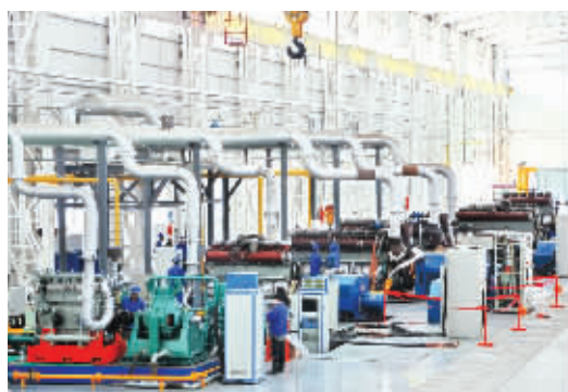
淄博新能源有限公司生产车间
